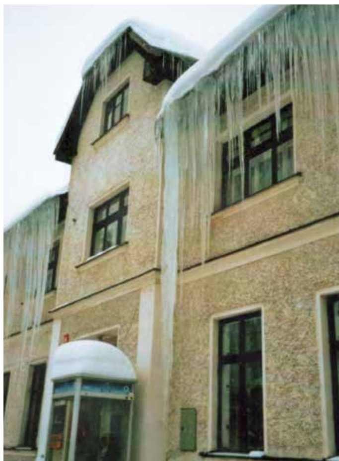
Velké zimy v Albrechticích – pošta s obrovskými ram-pouchy. Pošta v naší obci byla od roku 1889.
