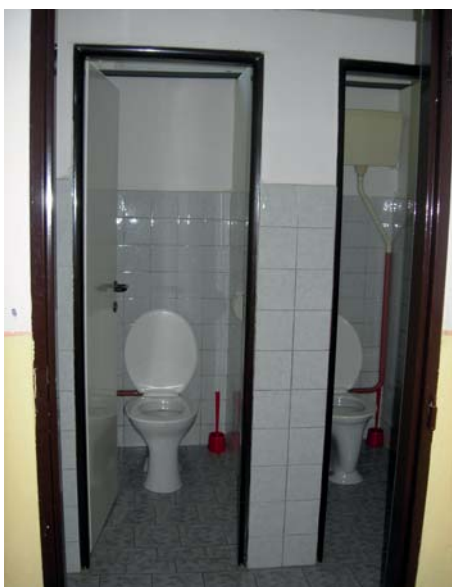
Současný stav dívčích toalet v základní škole
