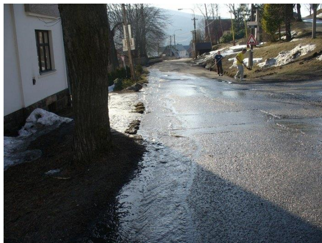
Jaro 2010. Každoroční tání sněhu přinášelo velké množství povrchové vody, která volně stékala po hlavní silnici a podmáčela sklepy přilehlých domů a vymílala krajnice hlavní silnice.
